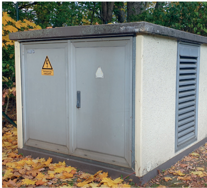
Kennzeichnen Sie Trafo, Sicherung und Zähler genau
