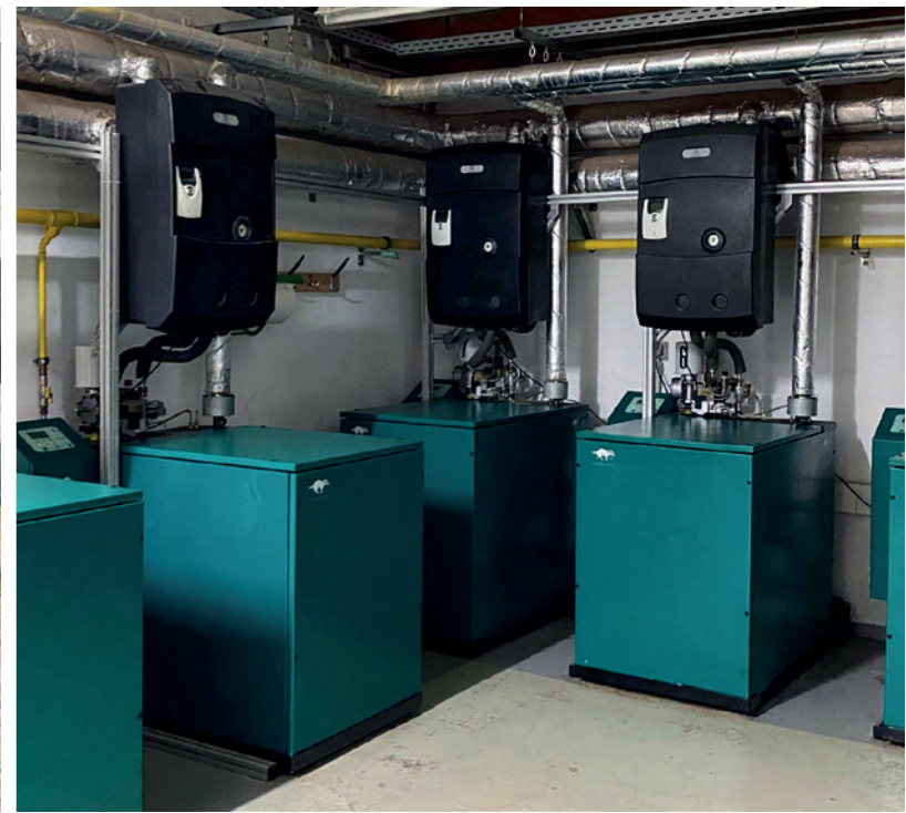
Kaskadierte KWK-Systeme bei der FrankenTherme
