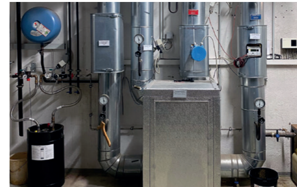
Wärmeübergabestation der Fernwärmeleitung, gespeist durch eine Biogasanlage auf dem Betriebsgelände der FrankenTherme in Bad Königshofen
